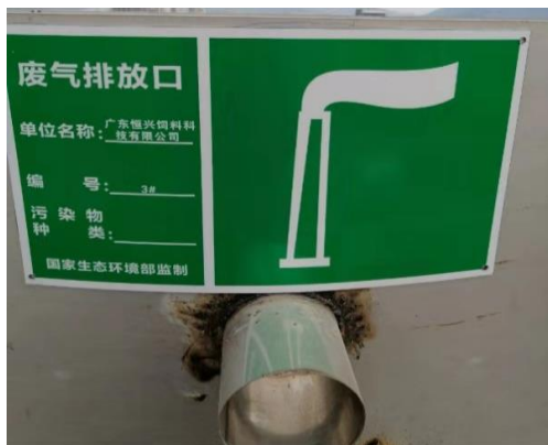
图 9-9 3#排放标识牌排放口
