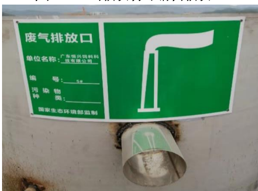
图 9-11 5#排放标识牌排放口
